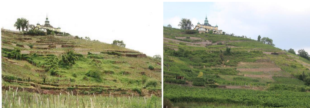
Abbildung 8: Stützmauern unterhalb des Spitzhauses in Radebeul 2006 (links) und 2018 (rechts)
